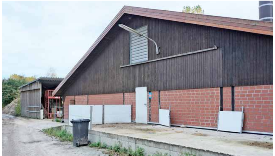
Als nachteilig erwies sich die Anordnung der Verloaderampe unterhalb des Giebelfensters, von wo die Zuluft in den Zentralgang geleitet wird. Mit Virus beladene Aerosole können so in den Stall gelangen.
